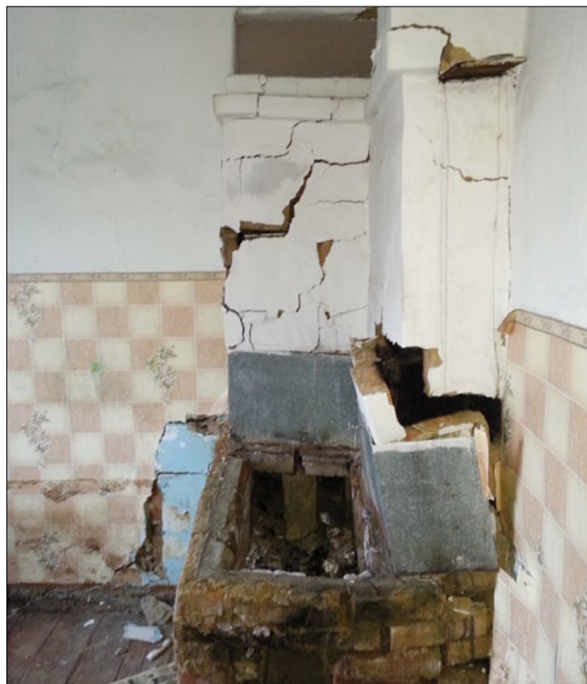
Рис. 7. Трещины в печи
