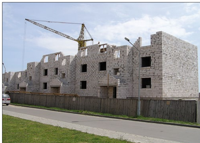
Рис. 2. Строительство многоквартирного жилого дома с несущими стенами из ячеисто-бетонных блоков (районный центр Клецк, Минская обл.)
