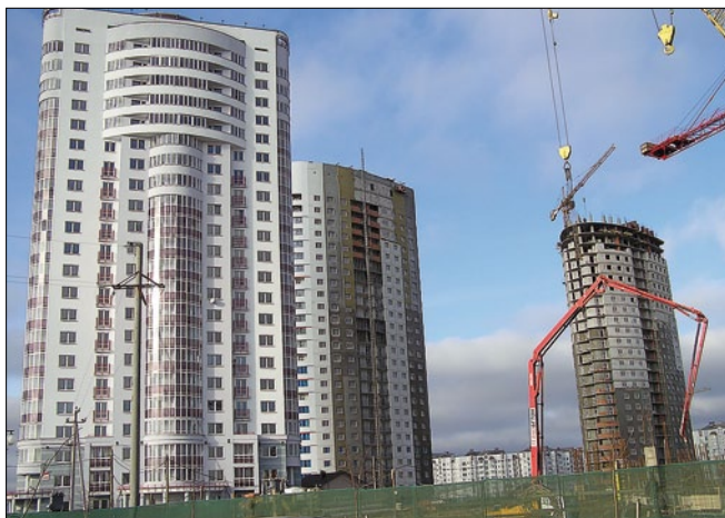
Рис. 3. Многоэтажные жилые здания с несущим каркасом из монолитного железобетона и поэтажно опертые стенами
