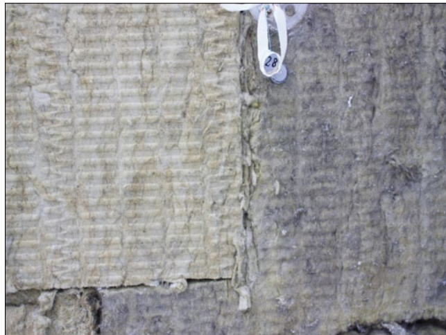
Рис. 2. Поверхность плиты из минеральной ваты, покрытая пылью (слева светлый, только что установленный кусок минплиты)
