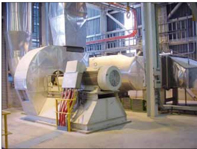
Рис. 3. Генератор горячих газов и главный вентилятор
