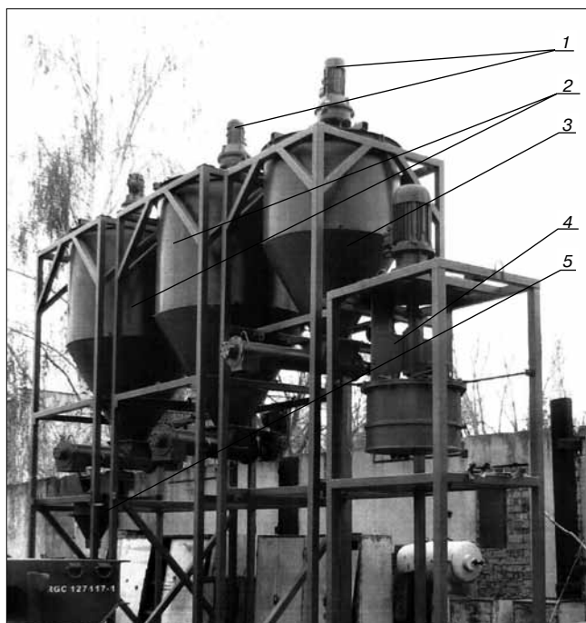
Рис. 4. Унифицированный технологический модуль УТМ-2 (Кишинев, 2010 г.): 1 – ворошитель сухих компонентов в расходных бункерах; 2 – бункеры для заполнителей; 3 – бункер вяжущего; 4 – смеситель-активатор вяжущего и воды; 5 – смеситель активированного заполнителя с водовяжущей смесью
