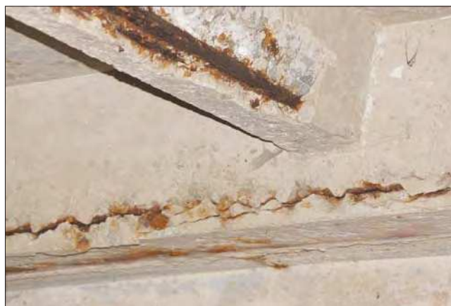
Рис. 2. Вид трещины отрыва защитного слоя бетона в растянутой зоне главной балки и оголение арматуры второстепенной балки монолитного перекрытия склада сельскохозяйственной продукции при разрушении бетона от коррозии арматуры (автор А.В. Куршпель)
