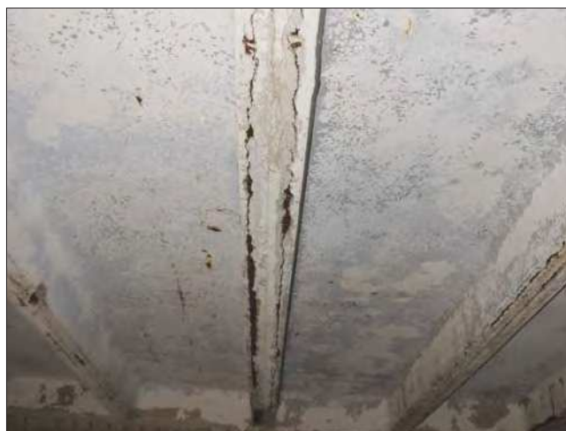
Рис. 3. Вид продольных трещин в ребрах П-образных сборных железобетонных плит в местах расположения напрягаемой арматуры и частичное обрушение защитного слоя бетона от коррозии арматуры в здании склада сельскохозяйственной продукции (автор А. В. Куршпель)
