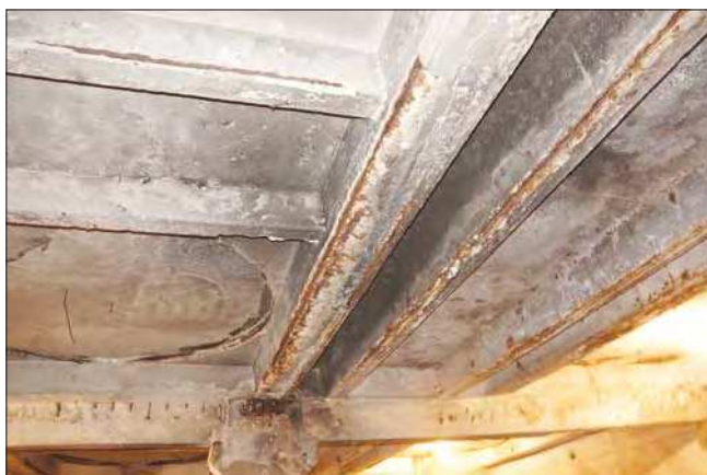
Рис. 1. Разрушение защитного слоя бетона в растянутой зоне железобетонных конструкций в подвале здания склада сельскохозяйственной продукции после 15 лет эксплуатации (автор А.В. Куршпель)
