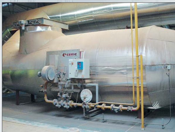
Оборудование CERIC на заводе фирмы Wienerberger в Пон-де-Во
