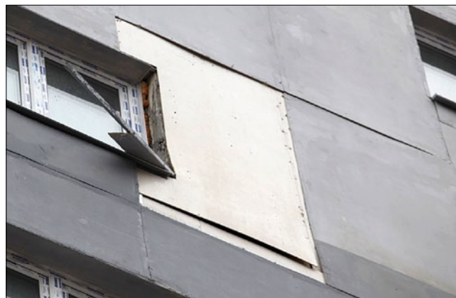
Рис. 5. В период дождей сильный ветер сорвал с увлажненных фасадов здания наиболее поврежденные листы
