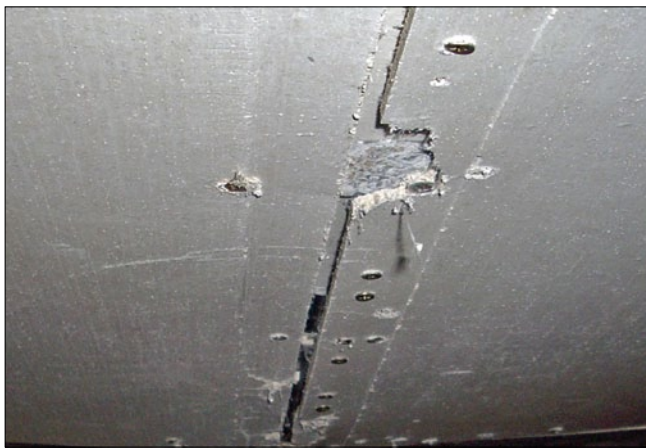
Рис. 3. При увлажнении воздуха в помещениях техподполья СМЛ получили повреждения, а после просушки стыковые швы недопустимо увеличились
