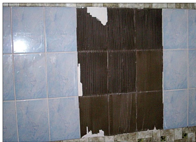
Рис. 2. Отслоение от СМЛ отделочной плитки
