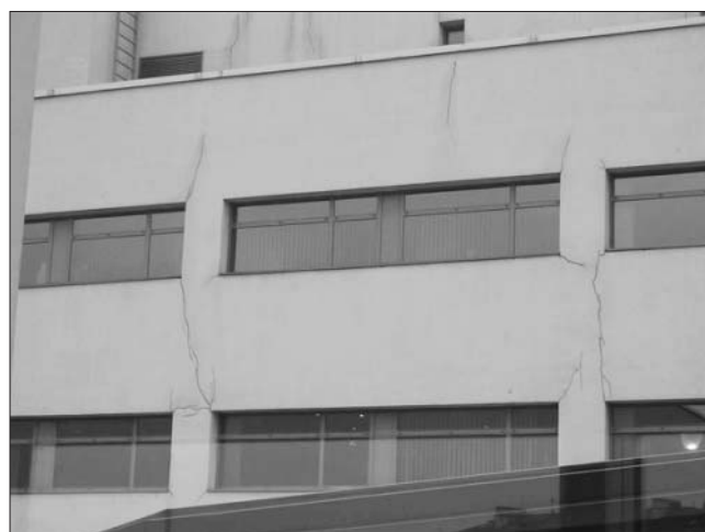
Рис. 5. Повреждения системы в реальных условиях (сквозные трещины декоративно-защитного слоя и базового слоя системы, отслоение базового слоя от утеплителя)
