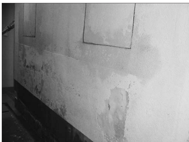
Рис. 4. Повреждения системы в результате проведения испытаний (замачивание системы, обрушение декоративно-защитного слоя, отслоение базового слоя от утеплителя)
