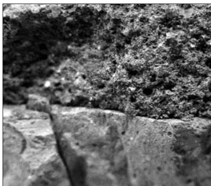
Рис. 2. Зона контакта кирпича и раствора
