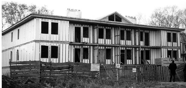
ООО «Строительство мансардных этажей» приступило к отделке двухэтажного десятиквартирного жилого дома из термоструктурных панелей «Радослав» в Костроме
