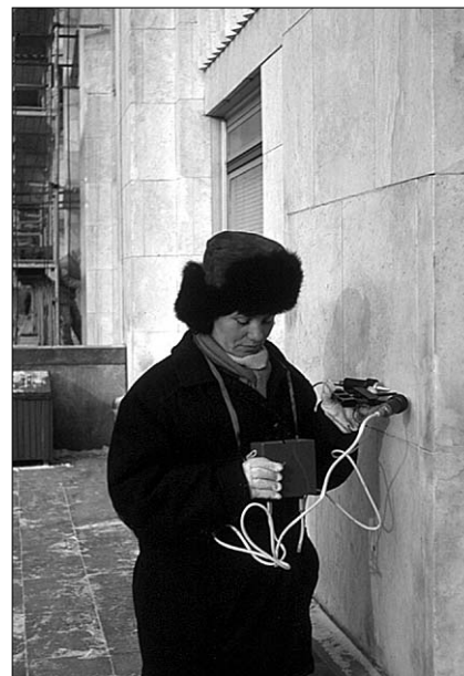
Рис. 2. Ультразвуковой контроль качества мраморных деталей в процессе ремонтно-восстановительных работ на Доме Правительства РФ
