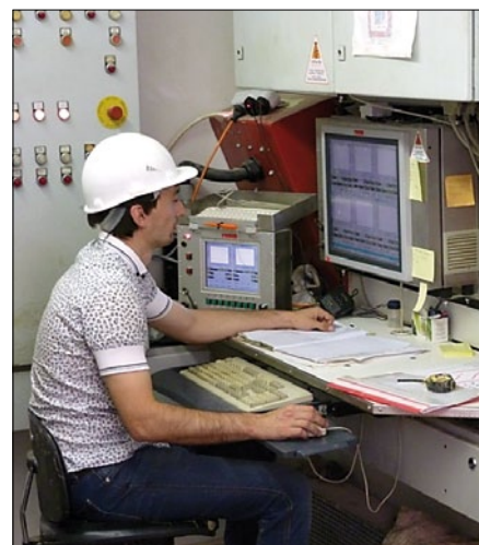
Одна из инъекционных насосных станций ООО «ГорГеоСтрой»
