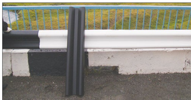
Рис. 6. Варианты использования защитных пластиковых панелей на дорожных ограждениях
