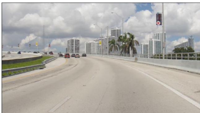
Рис. 1. Отсутствие видимости (контрастности) дорожной разметки на цементобетонных покрытиях
