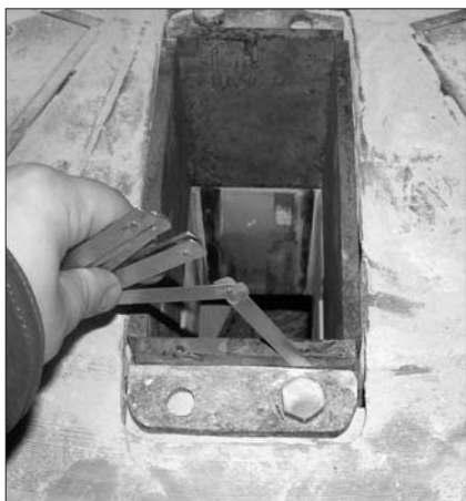
Рис. 4. Торцевые пластины установлены со слишком большим зазором
