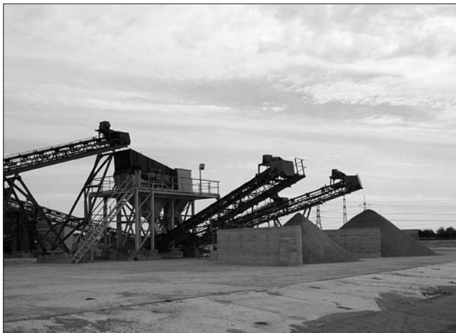
Рис. 3. Установка по производству кубовидного щебня на ОАО «ТСМ-Н»
