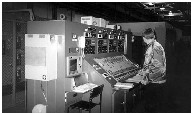
Пульт управления линией по производству стекла с низкоэмиссионным покрытием Sun Coatings Inc, установленной на пушкинском «Заводе архитектурного стекла»
