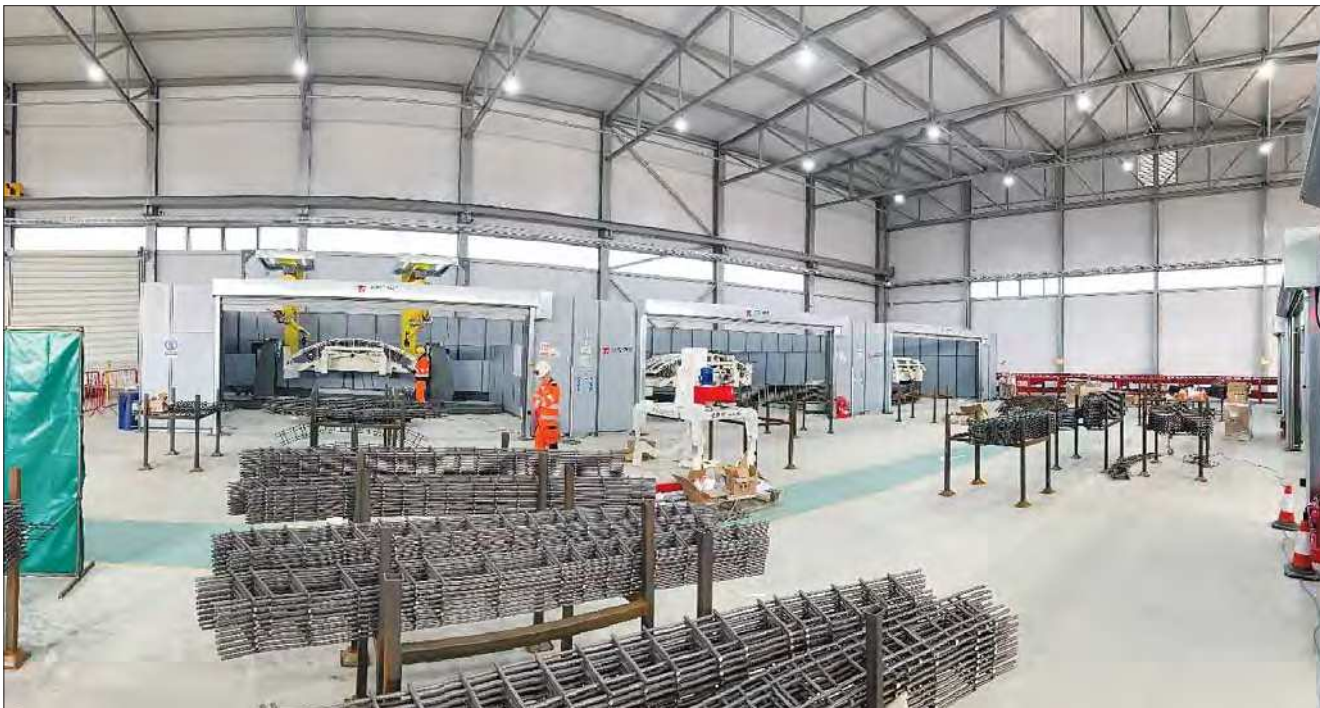
Предварительно изготовленные арматурные решетки свариваются с армосетками с помощью сварочных роботов (видны на заднем плане), образуя готовый армокаркас для элементов тоннеля
