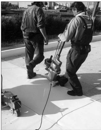
Механический способ крепления кровельных мембран. Материал Sikaplan 15 VGWT. Торговый комплекс «Метро Кэш энд Керри» (Москва)
