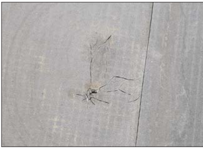
Рис. 3. Сквозные трещины в центральной части пятна
