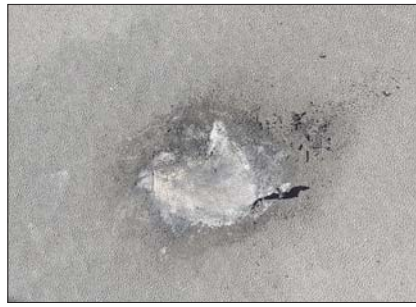
Рис. 4. Обесцвеченная поверхность покрытия под слоем птичьего помета
