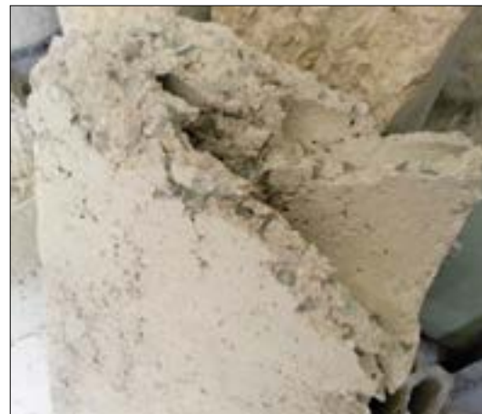
Рис. 3. Стеновой бетонный блок после разрушения
