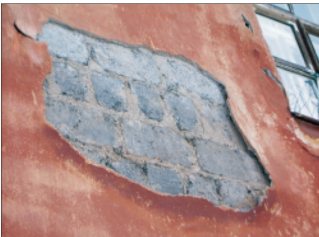
Рис. 7. Несмотря на постоянное отслоение наружной штукатурки, состояние гипсобетонных блоков хорошее (2008 г.)
