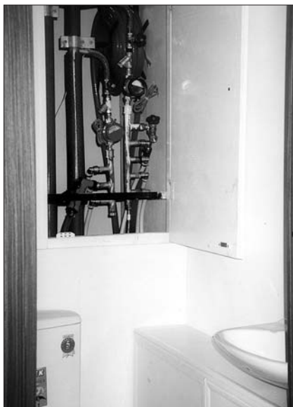
Сантехкабина ОАО «Калибровский завод» типа УК-1 отличается современной комплектацией. Здесь предусмотрены счетчики воды, выводы для стиральной машины, а в туалетной даже маленький умывальник
