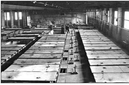
Рис. 2. Кольцевая печь каркасного типа со стенами из шамотоволокнистых блоков (Смоленский кирпичный завод)
