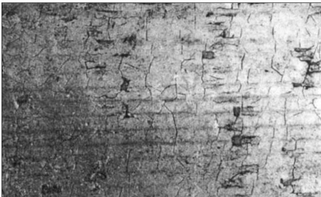
Рис. 1. Трещины в верхнем слое кровельного ковra
