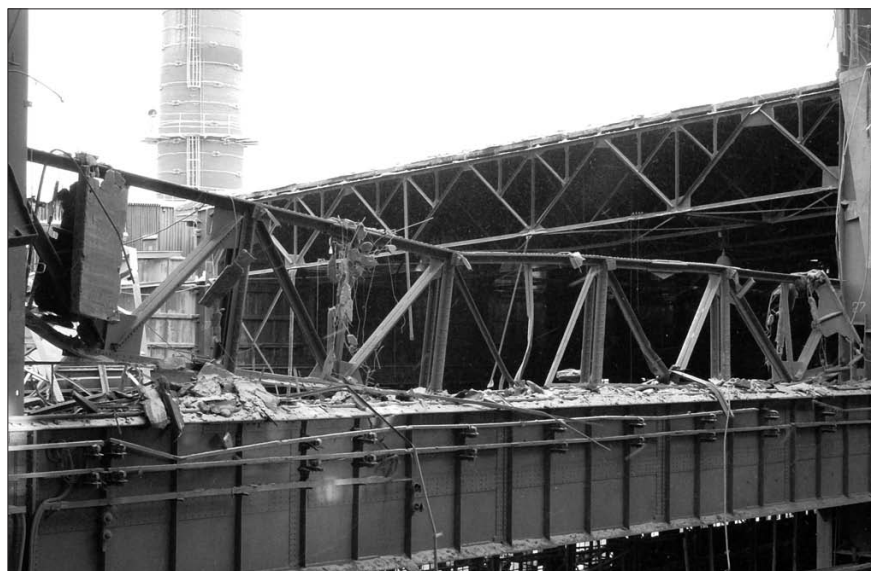
Рис. 1. Подстропильная ферма, упавшая на подкрановые пути
