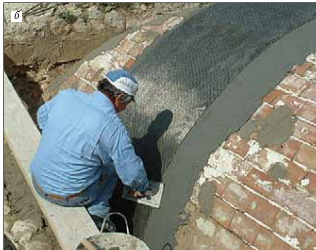
Рис. 6. Армирование кладки сетками из композитных материалов: а – состав штукатурного слоя с двумя сетками армирования; б – армирование каменного свода
