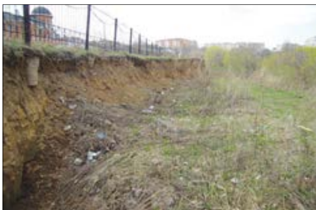
Рис. 2. Стенка срыва и головной блок оползня скольжения. Микрорайон «Волжский-1», г. Чебоксары (2006 г.)
