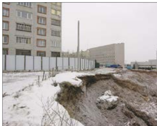
Рис. 5. В процессе инженерной подготовки строительной площадки искусственно созданы зоны геологических опасностей с техногенными оползнями (VI мкр., г. Чебоксары)
