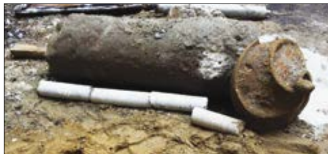
Рис. 8. Общий вид исследуемого нижнего фрагмента сваи после откопки
