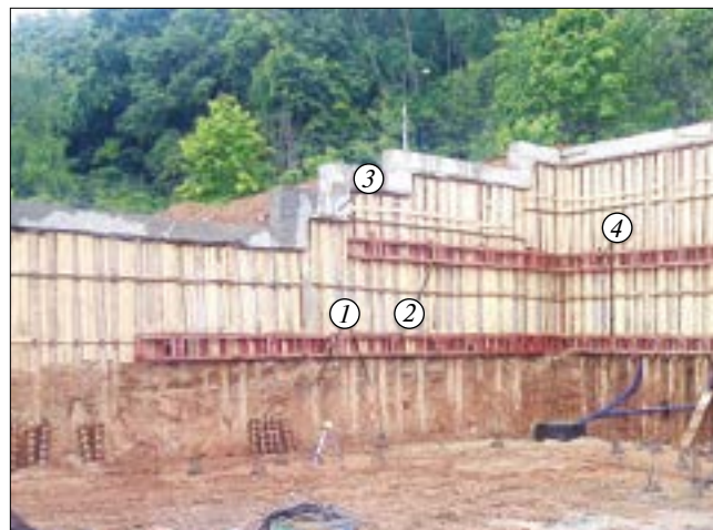
Рис. 8. Шпунтовая стенка для обеспечения устойчивости оползневого склона: 1 – сваи ЭРТ; 2 – грунтовые анкера ЭРТ; 3 – монолитный железобетонный обвязочный пояс; 4 – анкерный обвязочный пояс
