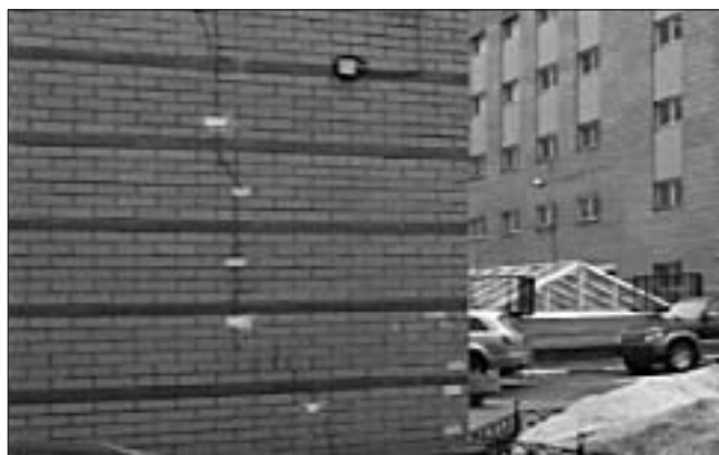
Рис. 2. Разрушение облицовочного слоя из лицевого пустотелого керамического кирпича в 18-этажном жилом здании (Москва, ул. Зоологическая)
