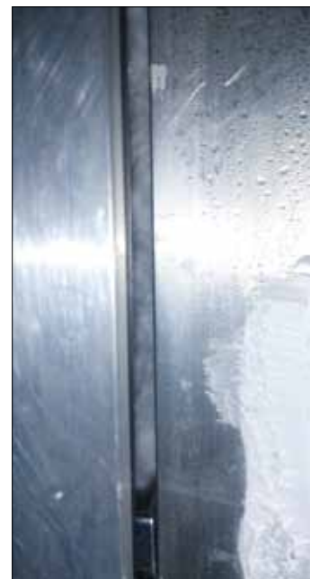
Рис. 5. Зазор между профилем створки и профилем рамы в центральной части оконного блока
