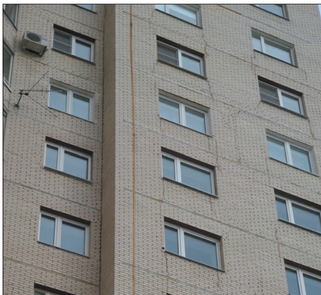
Рис. 2. Трещины на поэтажно-опертом лицевом слое кирпичной кладки
