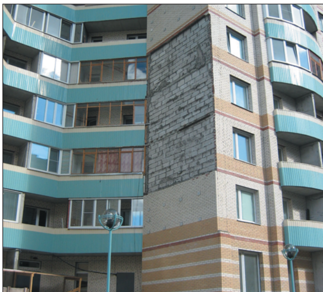
Рис. 1. Обрушение лицевого слоя кирпича
