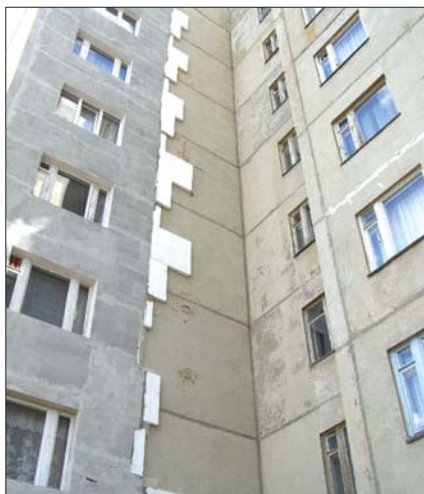
Рис. 4. Панельный жилой дом во время проведения ремонтных работ в 2009 г. (г. Ишимбай, ул. Докучаева, 14)
