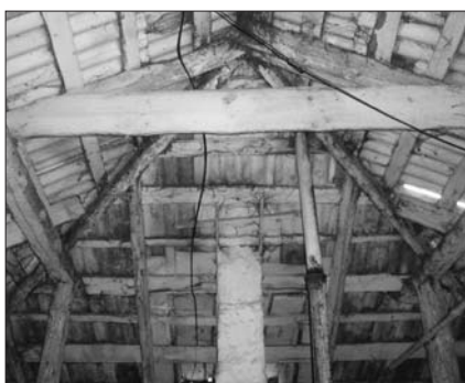
Рис. 6. Гниение, частичное разрушение деревянных стропил
