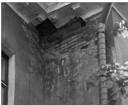
Рис. 2. Разрушение штукатурного слоя на наружной стены в месте замачивания атмосферными осадками
