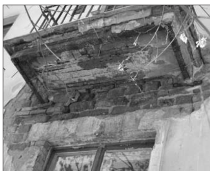
Рис. 5. Разрушение защитного слоя бетона балконных плит
