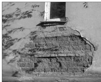
Рис. 3. Разрушение каменной кладки на наружной стены здания в месте расположения ванной комнаты
