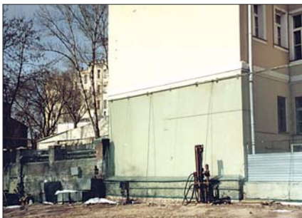
Рис. 4. Существующая аварийная подпорная стенка и оборудование для закрепления грунта
