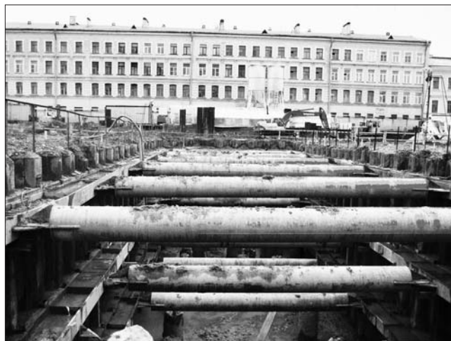
Рис. 2. Общий вид котлована второй сцены Государственного академического Мариинского театра. Эскавация выполнена до проектной отметки. Вид на Мариинский пер.
